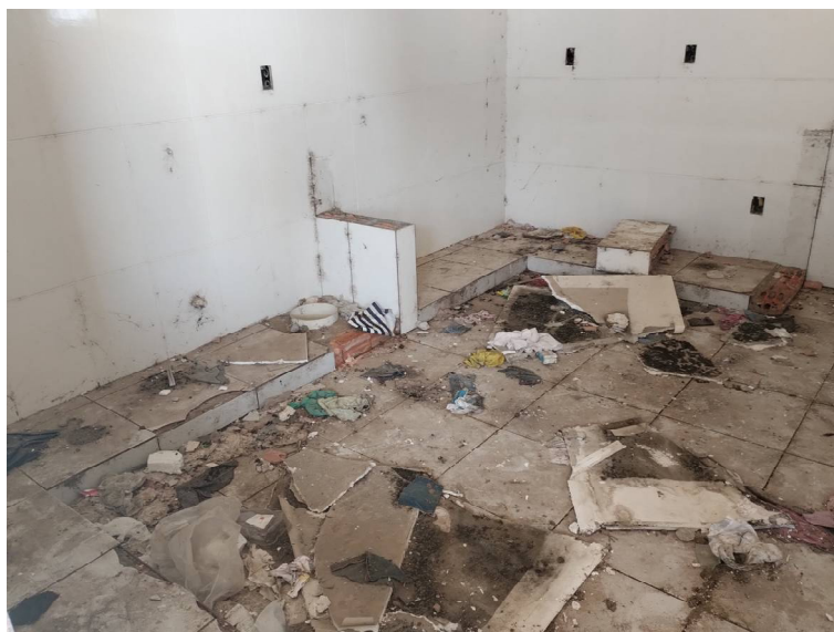
Figura 13 - Foto paredes de apoio das bancadas quebradas.
