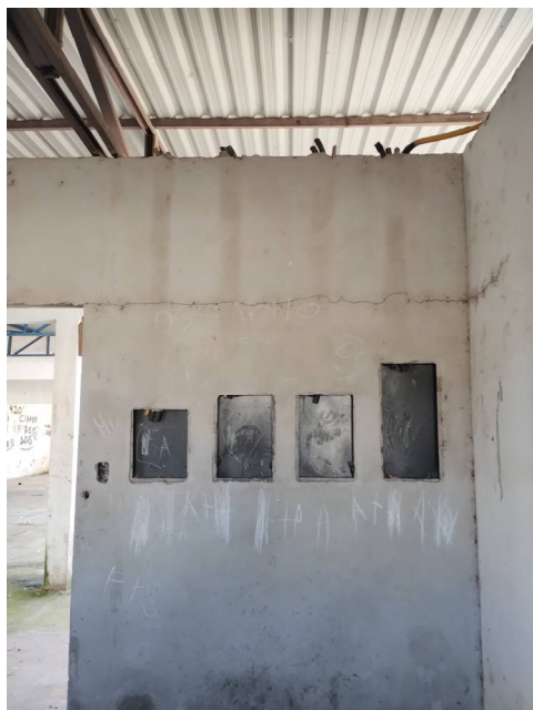
Figura 22 - Fotos sala Administração rachaduras devido a falta de contra-verga.
