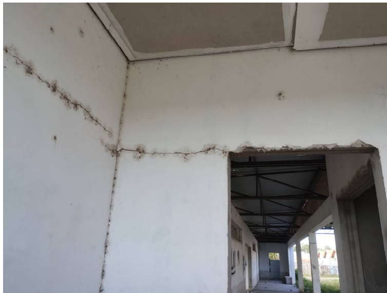
Figura 24 – Foto rachadura parede por falta de contra-verga.
