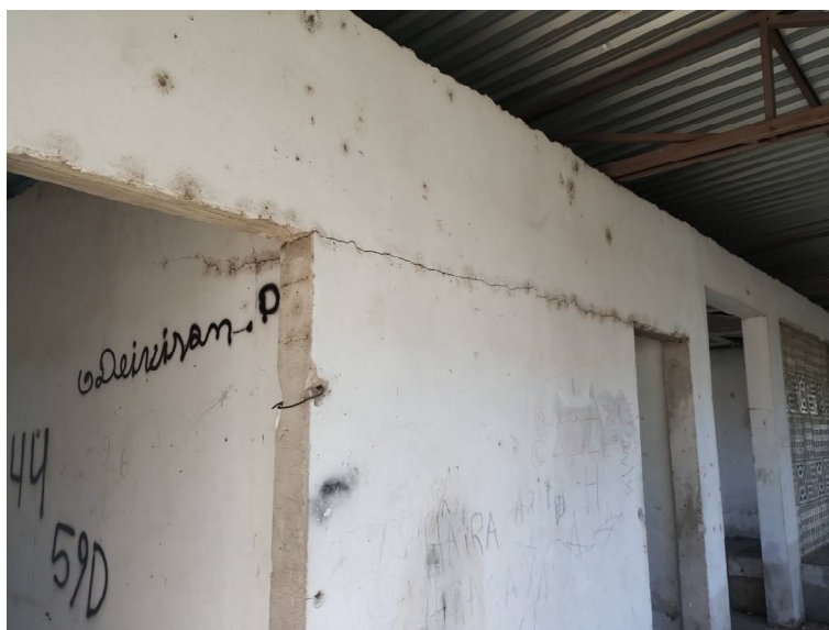
Figura 21 - Fotos rachaduras devido a falta de contra-verga.
