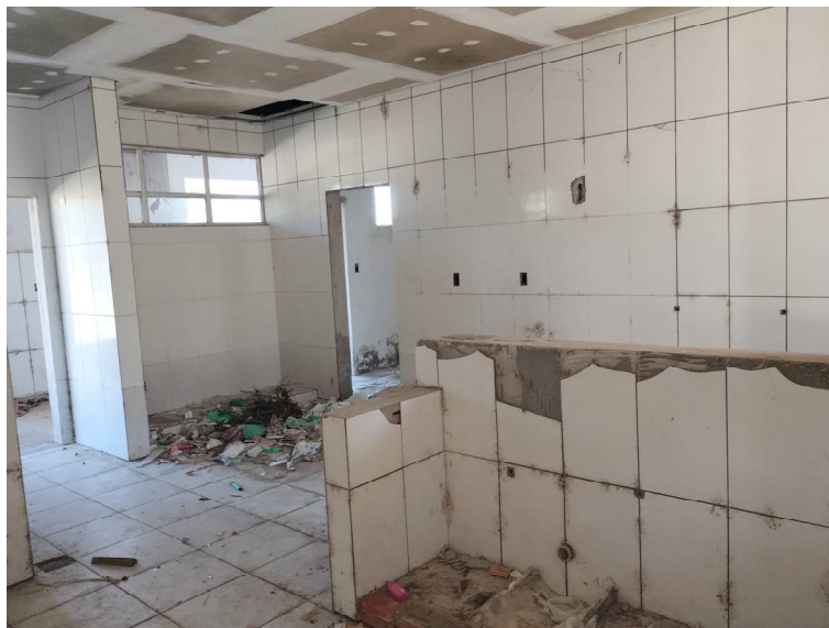
Figura 12 - Foto revestimento cerâmico quebrado e umidade do Gesso acartonado.
