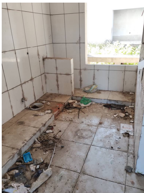
Figura 16 - Foto caixa de gordura e ralos entupidos, quebrados sem tampa.
