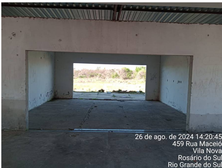
Figura 23 – Foto sala multiuso com rachaduras contra-piso, soleira arrancada.
