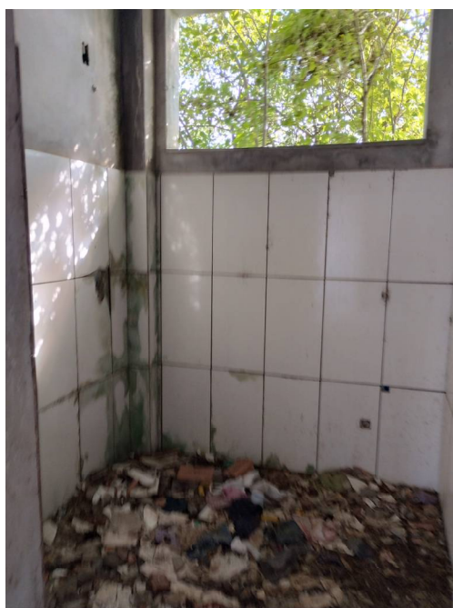
Figura 17 - Foto infiltração de água pela calha e telhado.
