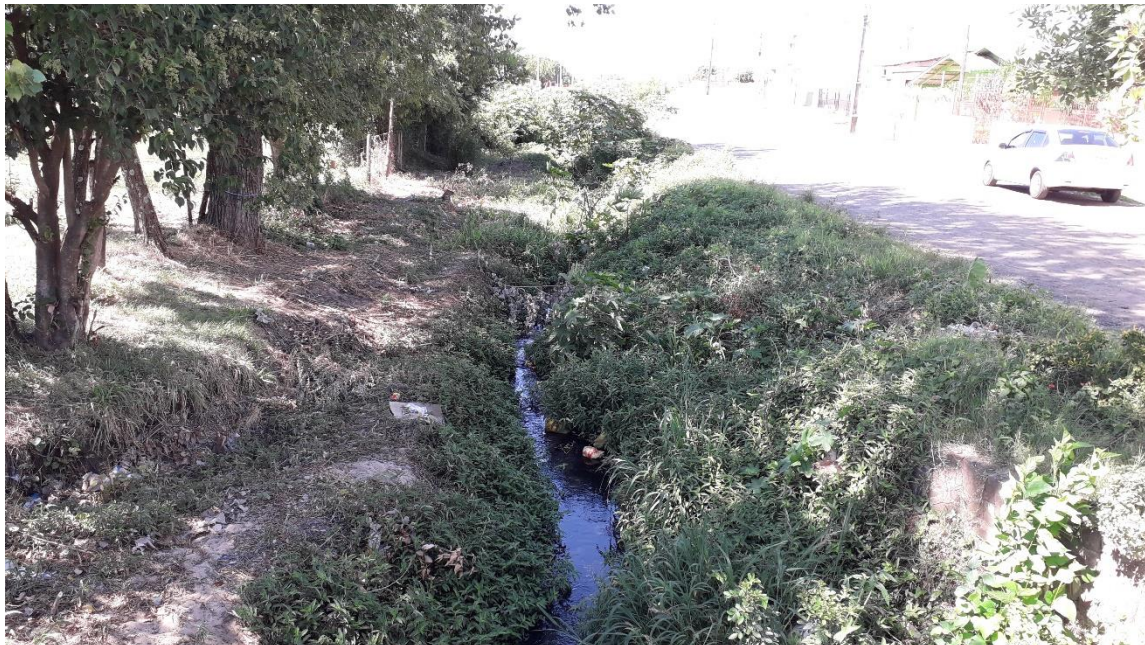
Foto 2: Esgotamento sanitário a céu aberto – Rua Delíbio da Fontoura
