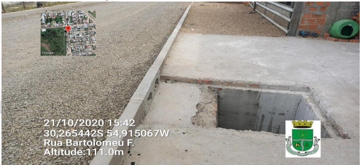
Foto 50: Sistema de drenagem
