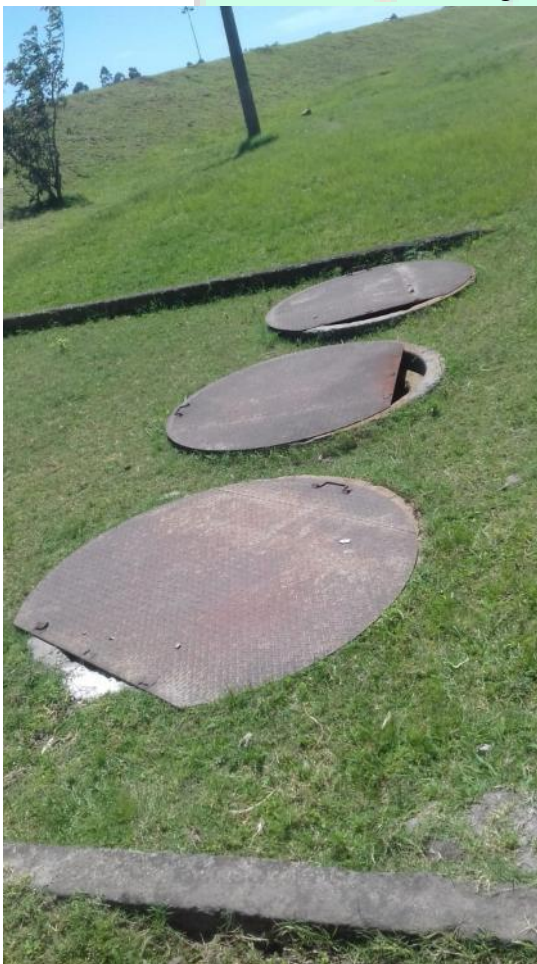
Foto 19: EBE 02 – Recebimento de Esgotos - Bairro Santo Antônio
