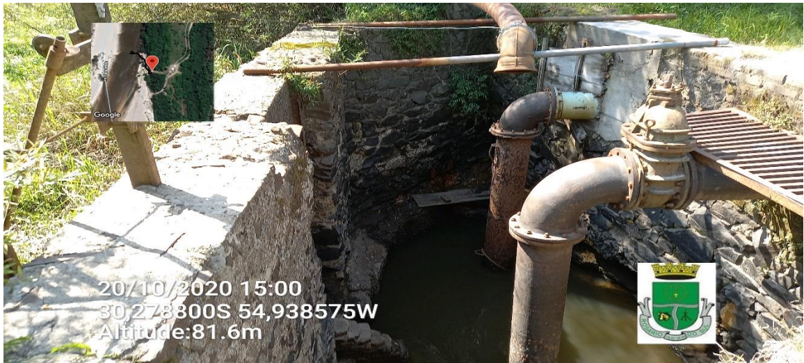
Foto 4: Ponto de captação de água bruta
