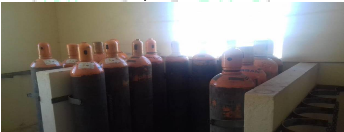
Foto 11: Setor de armazenamento de gás cloro na ETA.
