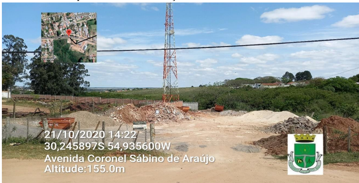
Foto 39: Resíduos provenientes da construção civil
