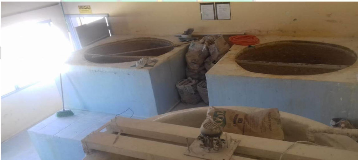
Foto 10: Setor de armazenamento de cal e sulfato de alumínio na ETA.
