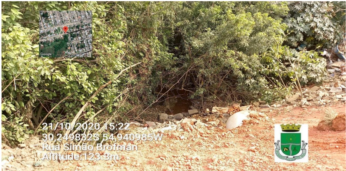
Foto 52: Sistema de drenagem
