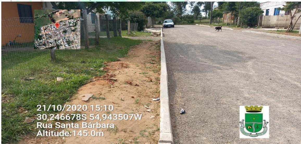
Foto 54: Sistema de drenagem
