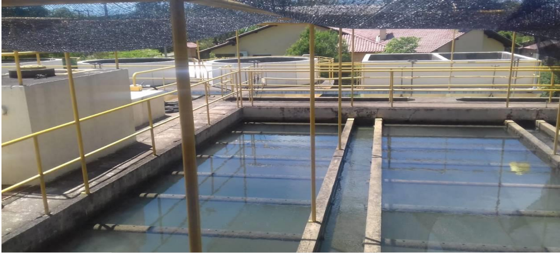
Foto 9: Vista geral do tratamento de água
