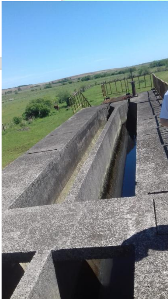
Foto 21: EBE 03 – Recebimento de Esgotos - Bairro Vila Nova
